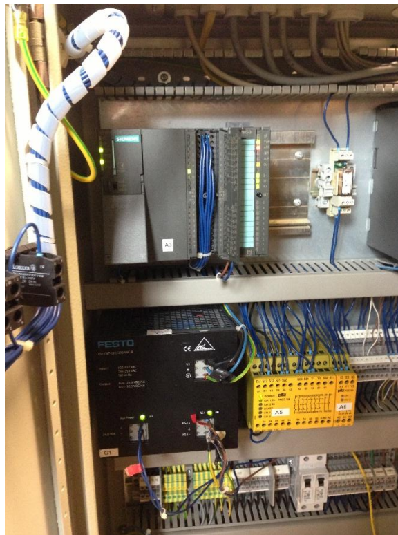
ภาพที่ 4-1 การซ่อมแซมอุปกรณ์ควบคุมการทำงานของชุดทดลองพีแอลซี
