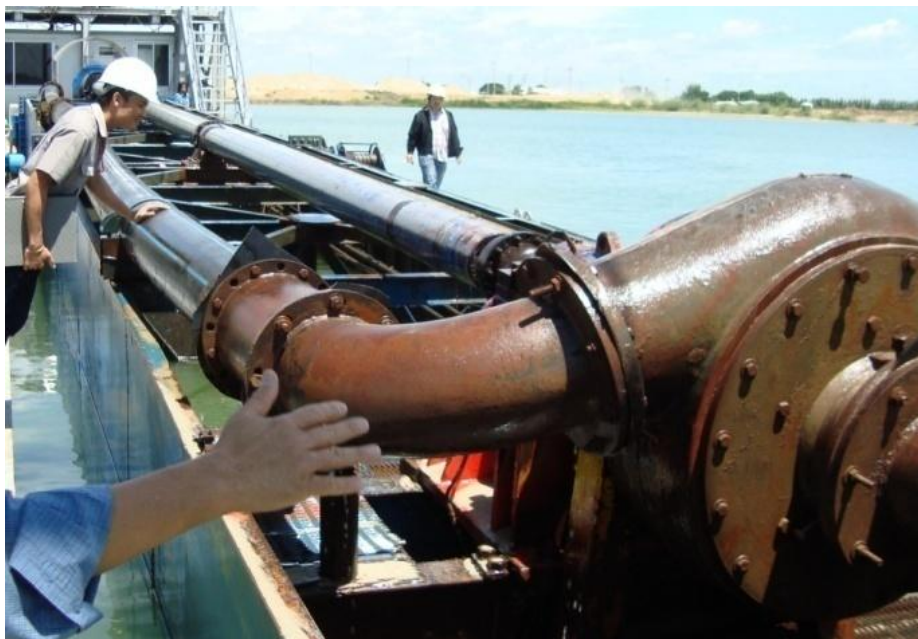
ภาพที่ 2.91 ตำแหน่งการติดตั้งปั๊มดูดทรายบนเรือ
