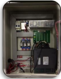
ภาพที่ 6 ตัวคอนโทรลของระบบควบคุมปั๊มไฮดรอลิกส์
