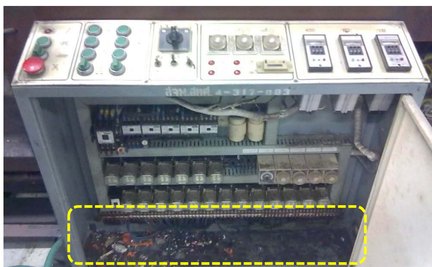
ภาพที่ 3-7 สภาพความเสียหายของตู้ควบคุม
